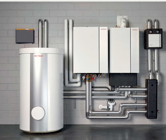
Hybridanlage bestehend aus Gas-Brennwertgerät und Split-wärmepumpe.
